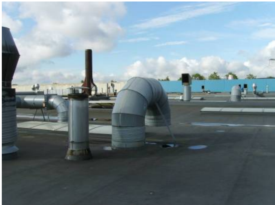
19 Indsugning til Dantherm varmluftovn
