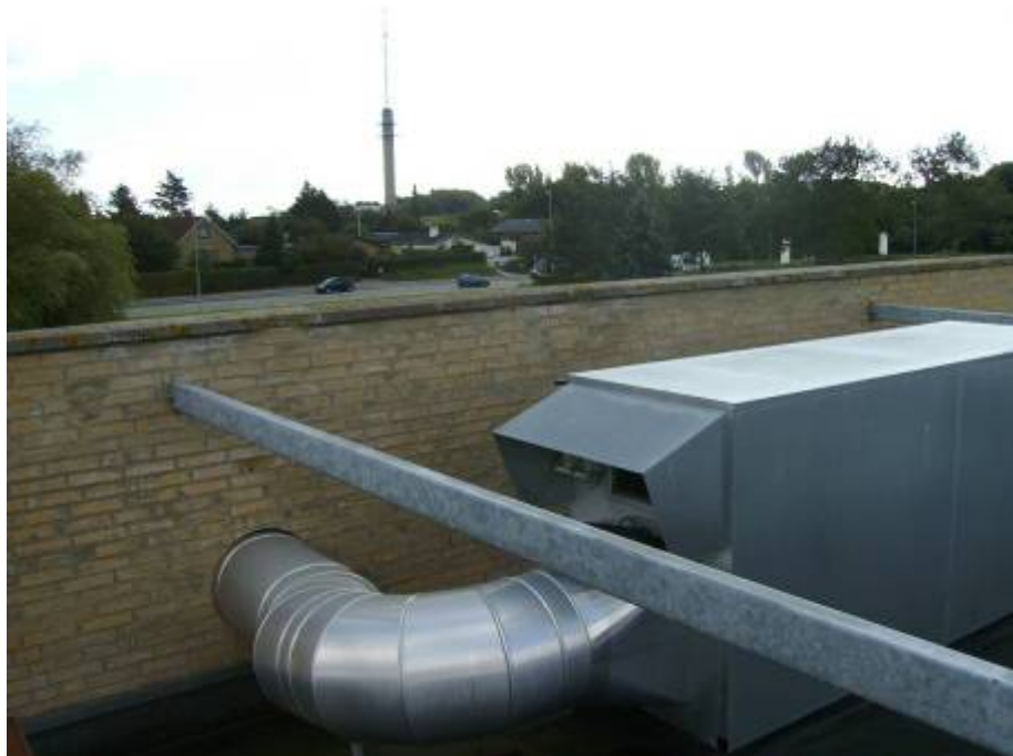
23 Ventilationsanlæg til kantinekøkken
