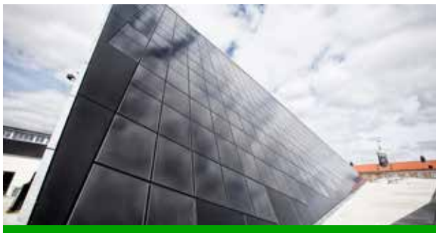
Solceller Kulturproduktionscenter Godsbanen.
