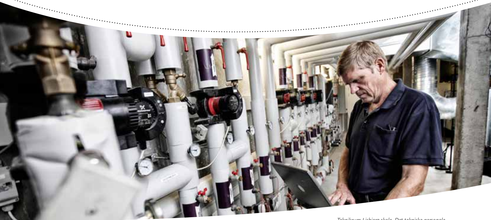
Teknikrum Lisbjerg skole. Det tekniske personale kan styre CTS-anlæg via bærbar PC.
